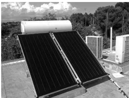
Instal·lació de panells tèrmics tubulars de baixa temperatura.
